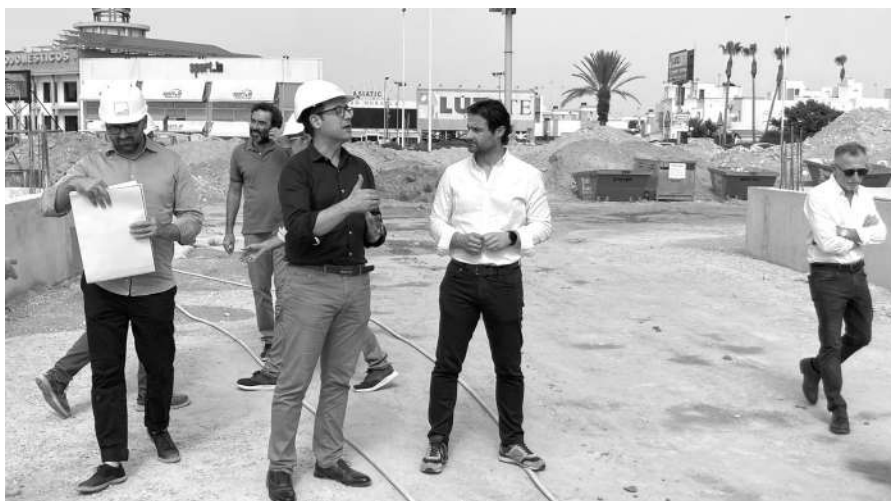
El alcalde, Eduardo Dolón, y el director general de Infraestructuras Educativas de la GV, Víctor García, visitando las obras del CEIP Amanecer.
